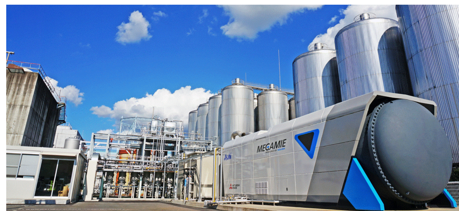
アサヒビール茨城工場で稼働中の、排水処理副生バイオメタンガス精製プラントと、今回精製メタンガスで発電している200kW固体酸化物燃料電池 (SOFC) Wastewater treatment plant, Biomethane gas refining plant, and the 200 kW solid oxide fuel cell (SOFC) in operation at the Asahi Breweries Ibaraki plant.
