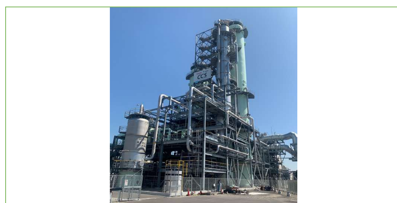
図2 バイオマス発電所から排出されるCO 2 を分離回収する世界初 注1 の大規模BECCS 注2 対応設備 Fig.2 The world's first large-scale carbon capture plant with BECCS capability for Mikawa power Plant in Omuta city in Kyushu
