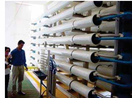
Desalinization plant (Tunisia)
