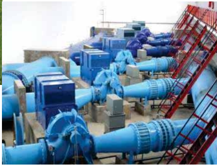
Irrigation pump (Tunisia)
