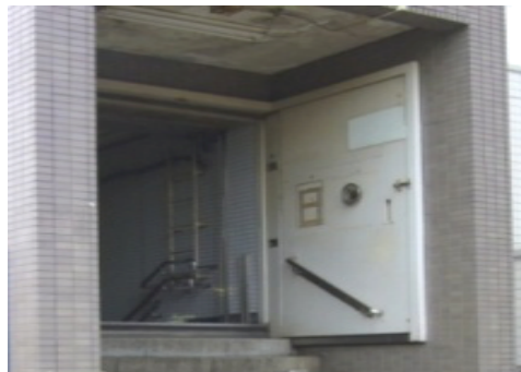
Tide protection door
